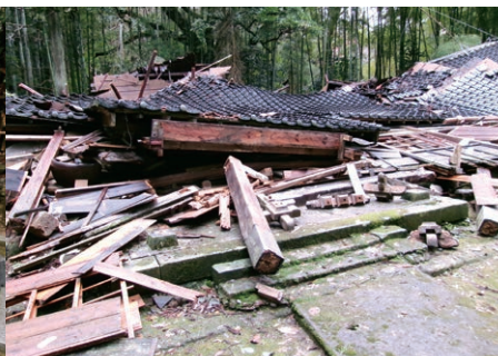
倒壊した本堂
